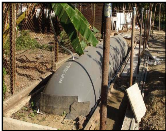
Biodigestor instalado y funcionando.
